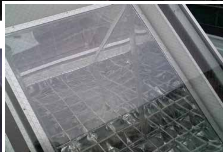
拡大 (光ダクト)
